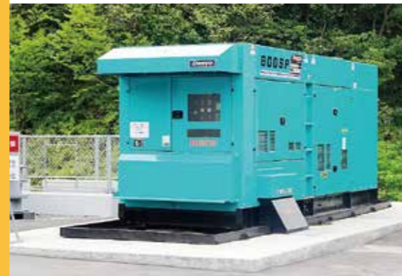
試験用発電機 800kVA
