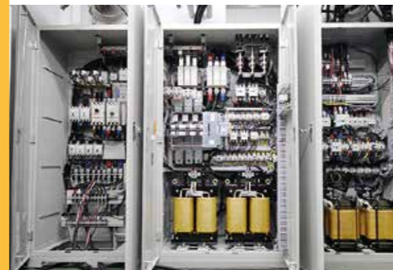
試験用制御盤 (開放時)
