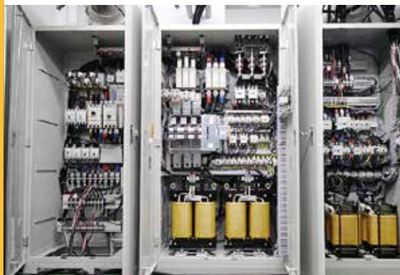
試験用制御盤 (開放時)
