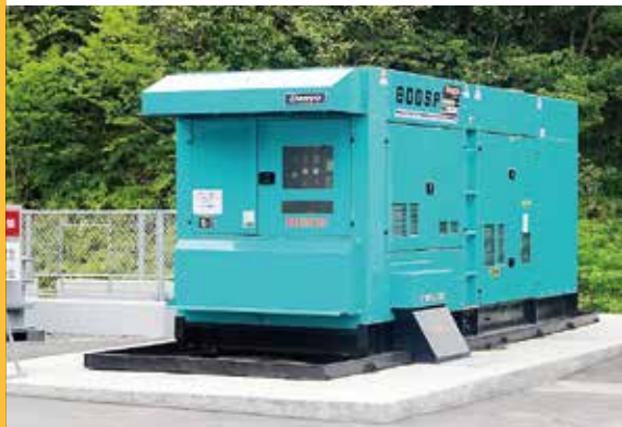
試験用発電機 800kVA
